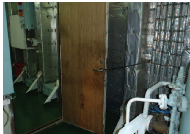
Fire door tied open
